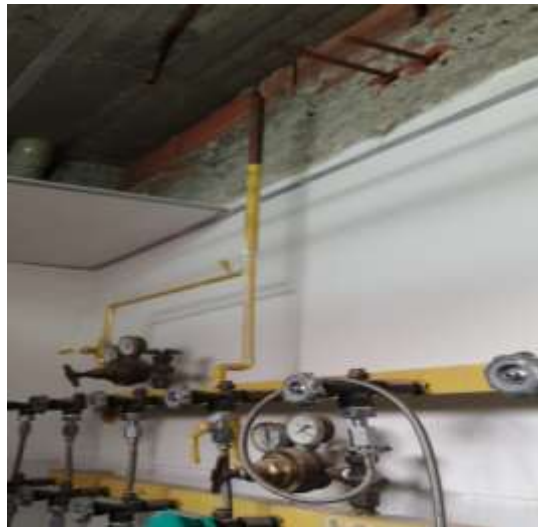
Salida de red de central de gases hacia pasillo
