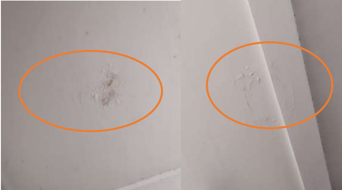
*Humedad en el área administrativa
