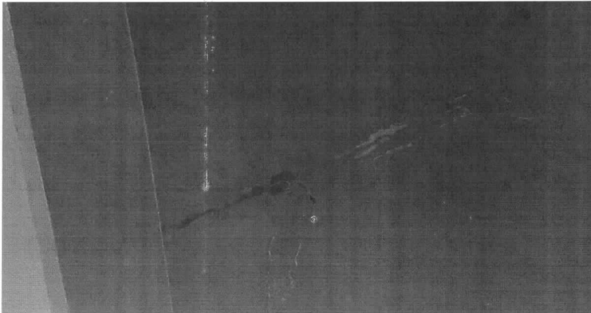
Fotografía No. 6: Grietas en el techo de los baños
