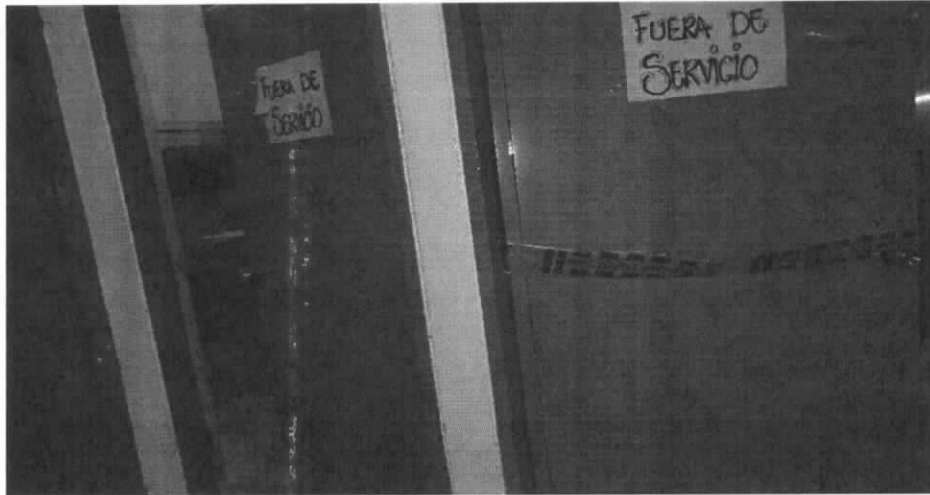
Fotografía No.1 Baños fuera de servicio
