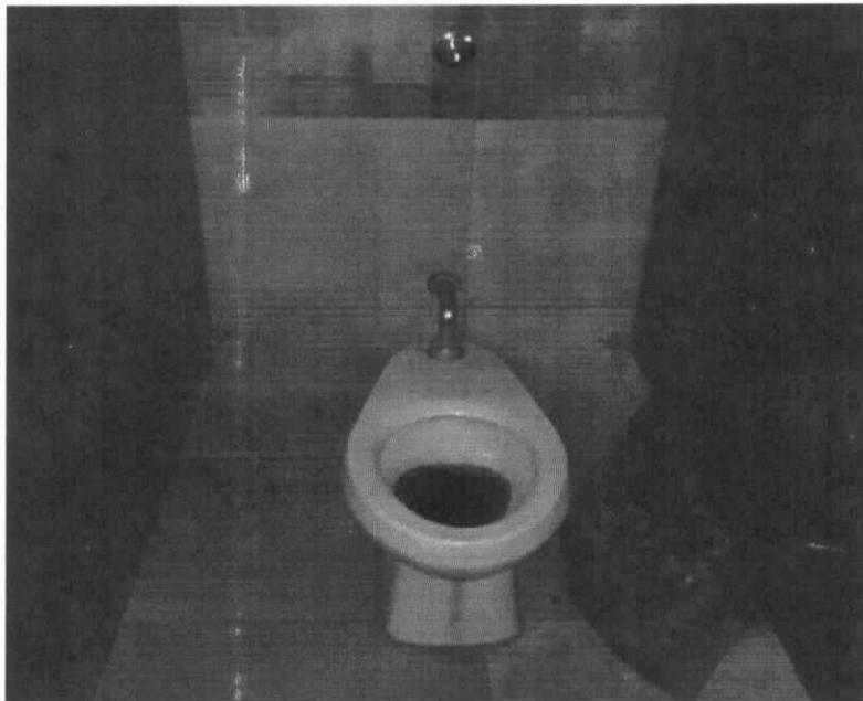
Fotografía No. 4: Baterías sanitarias deterioradas por falta de mantenimiento
