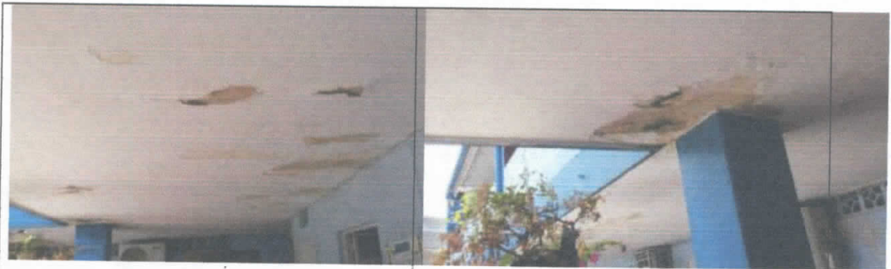
Humedades presentes en techos del pasillo
